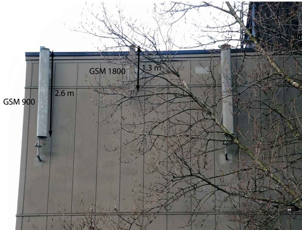
Figur 1: Basestasjon for mobiltelefoni på industribygg ved Ensjø T-banestasjon. To ulike antenntyper er i bruk, for to ulike frekvensområder. Legg merke til tiltingen litt oppover for antennene (kommer lettest til syne i antennen helt til høyre i det øvre bildet).
