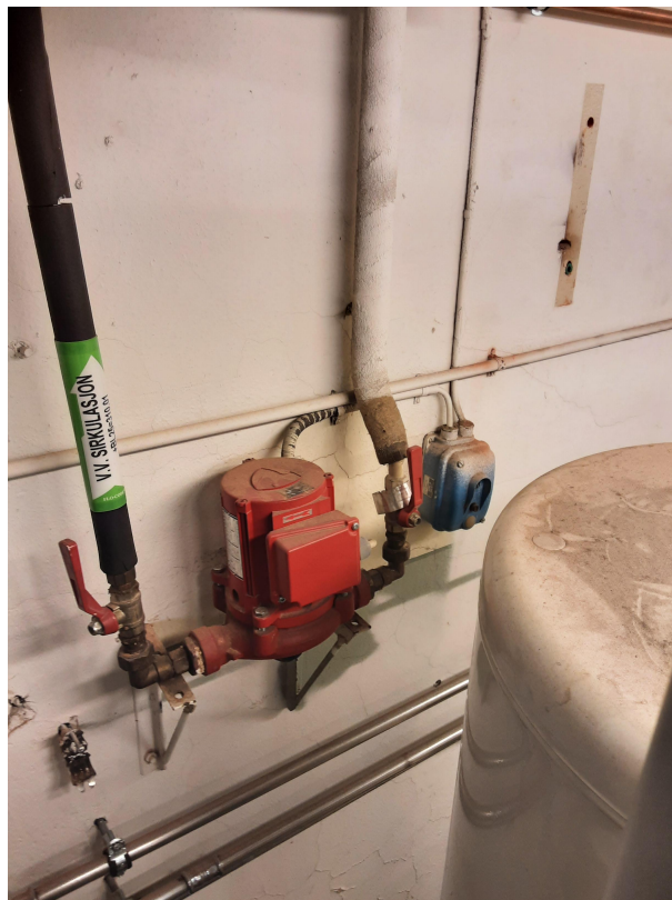
Skjema: "Risikovurdering Legionella : BL25" Spørsmål: SIRKULASJONLEDNING? VVC, VVX? Beskrivelse: Sirkulasjonspumpe, Filnavn: IMG_20220920_115320.jpg
