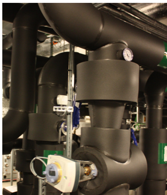
Teknisk rom: Egen brønnpark erstatter fjernvarme. Det er boret 230 meter ned under bygningen for å hente opp varme.
