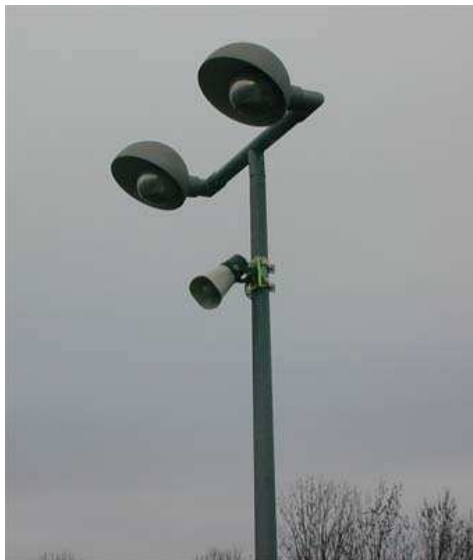
Figur 7. Høytaleranlegg på t-banestasjon.
