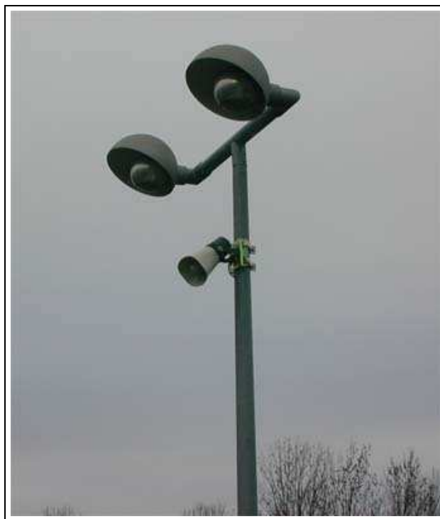
Figur 7: Høytaleranlegg på t-banestasjon
