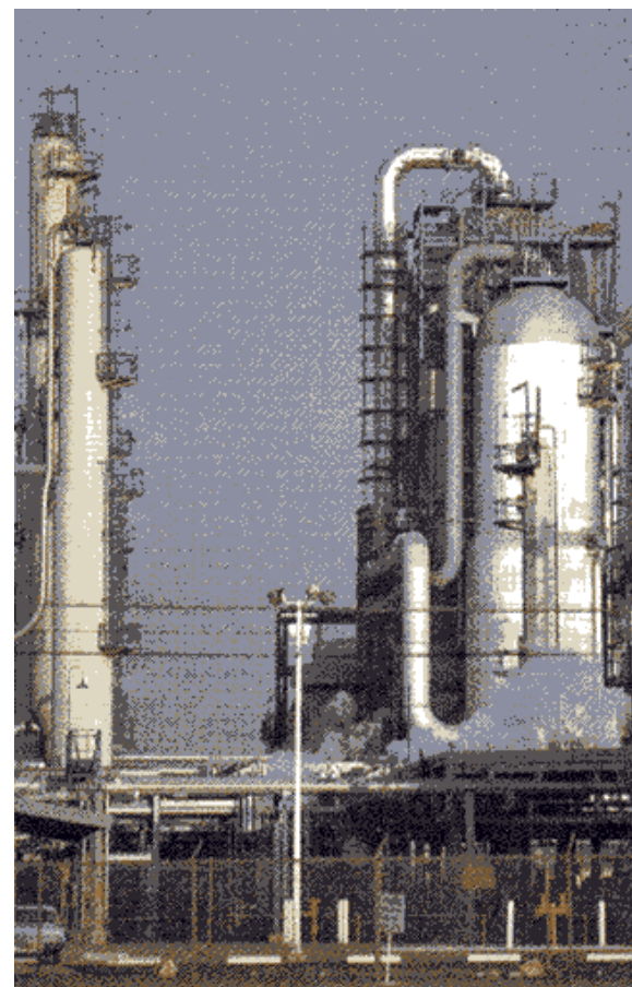
Destillasjonstårn og cracker
