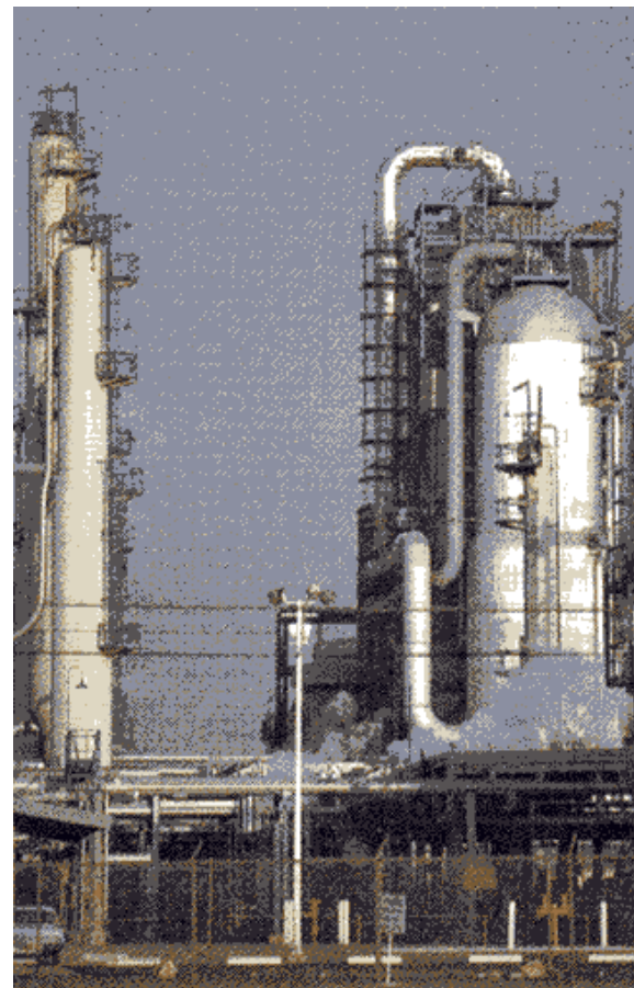
Destillasjonstårn og cracker
