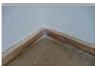
Overgang mellom gulv og vegg
