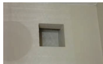
Luftekanal i vegg
