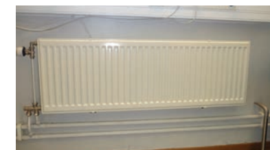
Radiator av nyere dato
