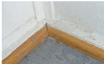
Overgang mellom gulv og vegg
