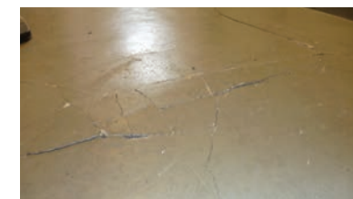
Malt betong gulv med setningskader
