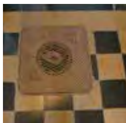
Inspeksjonsluke av støpejern
