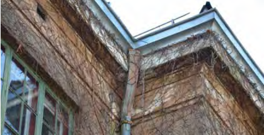
Øvre del av nedløpet er gammelt. Det runde nedløpet er nyere.
