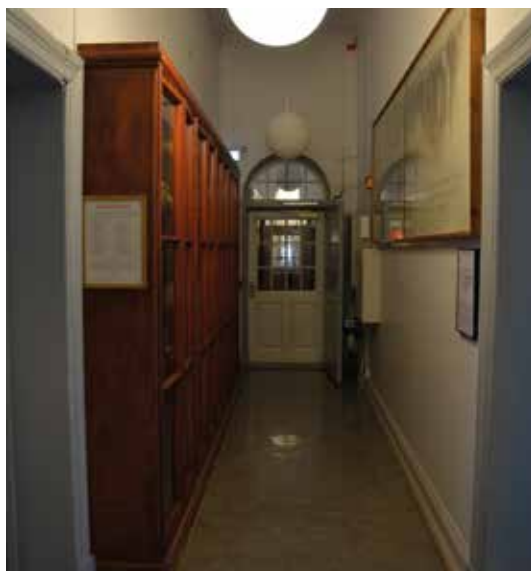
Korridoren sett mot vestibylen. Nyere pendelbelysning i himlingen. Eldre skap med glass i dørene.
