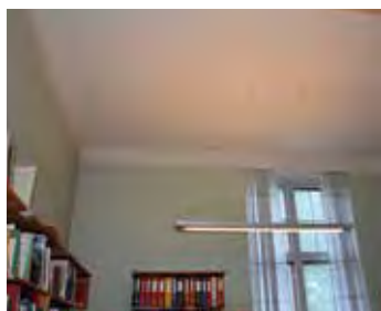
Himlingen er pusset og malt, trolig som opprinnelig.
