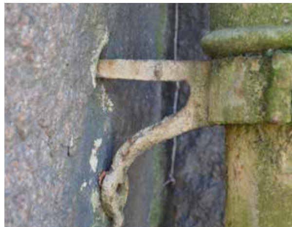
Feste i veggen for nedløp/soilrør av jern.
