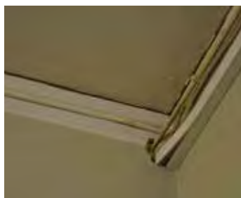
Himlingen er pusset og malt med nyere maling.
