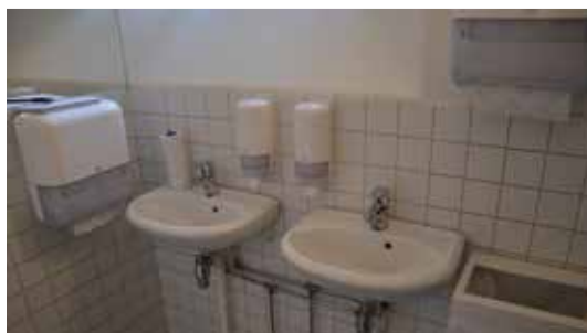
Under: Moderne sanitærinneordning
