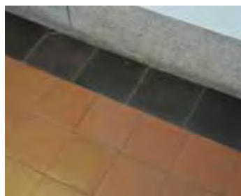
Gulvet øverst i trappen er belagt med eldre fliser, trolig fra 1960-tallet.
