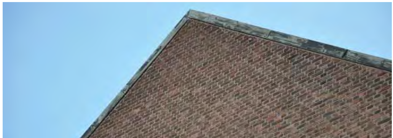
Gavlveggen mot nord var opprinnelig planlagt med en tverrfløy mot Geologisk museum. Vegg har blitt stående med blankmur og beslag av kobber.
