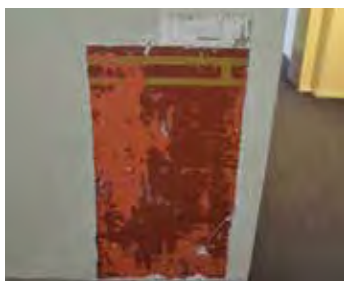
Et felt av tapetet på veggen er fjernet, eldre maling vises under.
