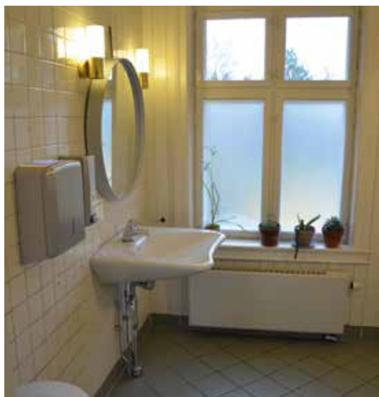
Over: Rommet er innredet med nyere sanitærutstyr.
