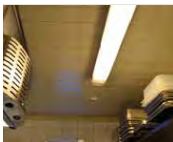
Nyere faspanel i himlingen.
