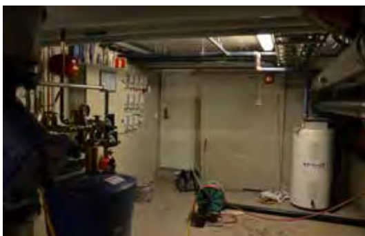
Under: Sett mot vest. Teknisk inventar og diverse rørføringer.
