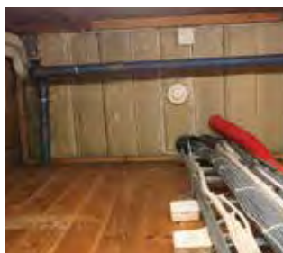
Teknisk rom sett opp mot himlingen.
