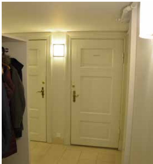
Over: Eldre fyllingsdører til toalettene. Nyere overflater.
