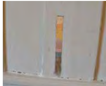
Farge-trapp på veggpanelet.
