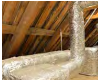
På loftet er nyere ventilasjonsanlegg.
