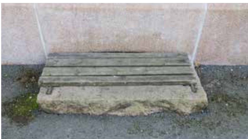
Lysgrav i grunnmuren
