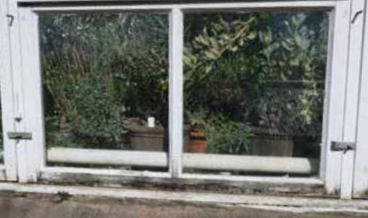
Vindusrammene i veksthusene er sterkt utsatt for råteskader.
