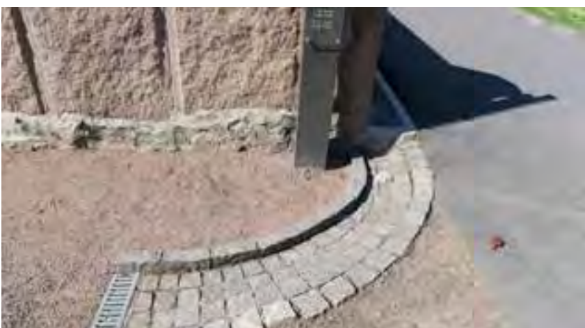
Brosteinsrenne ved nordøstre hjørne
